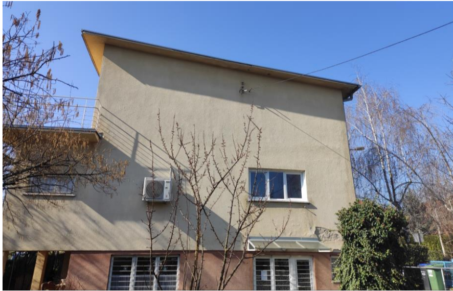
Foto prikaz postojećeg stanja nakon potresa
