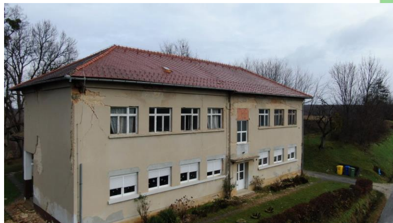
Oštećena zgrada škole Gornji Hruševac
